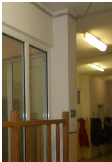
Figura 4.14 - Particolare dei corpi illuminanti ubicati nei corridoi
