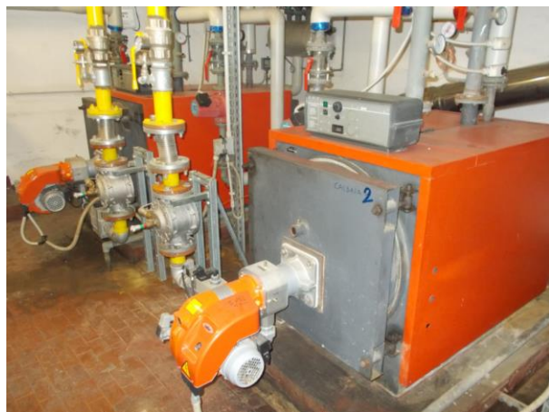
Figura 4.9 - Particolare del generatore di calore n.2
