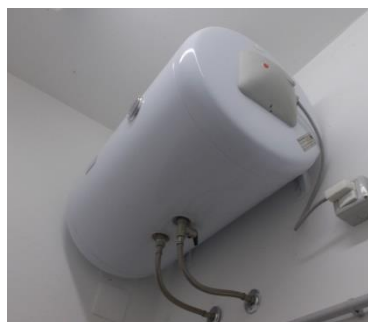
Figura 4.11 - Particolare di un boiler elettrico per la produzione di acqua calda sanitaria
