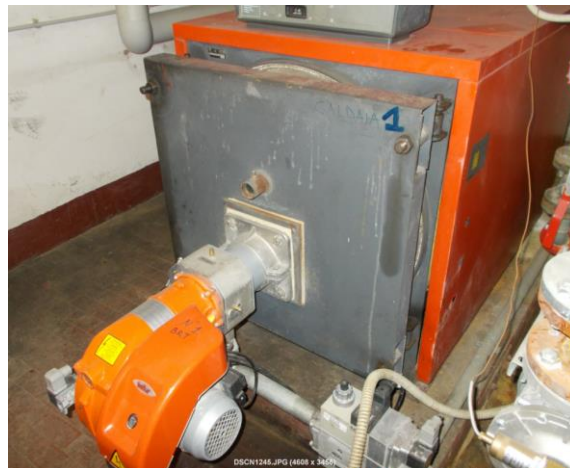
Figura 4.10 - Particolare del generatore di calore n.1
