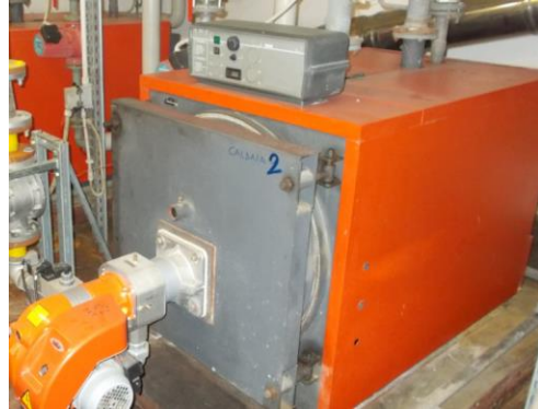
Figura 8.4 – Particolare della caldaia
